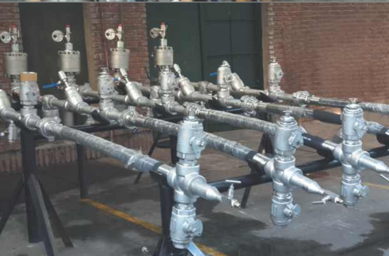
puentes de inyección injection manifolds / manifolds de injeção
